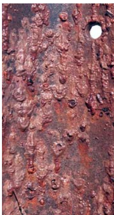
Figure A5-2 : Rouille interne d'un chauffe-eau de 20 ans.
